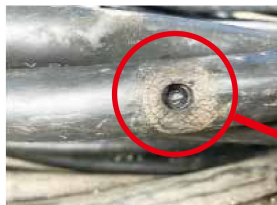
高圧ケーブル事故点
