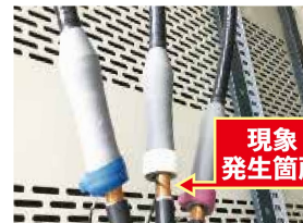
現象発生状態
