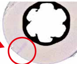
高圧ケーブル断面
